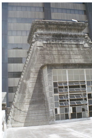
Figura 5 e 6- Estado físico das cúpulas ANTES da restauração.
